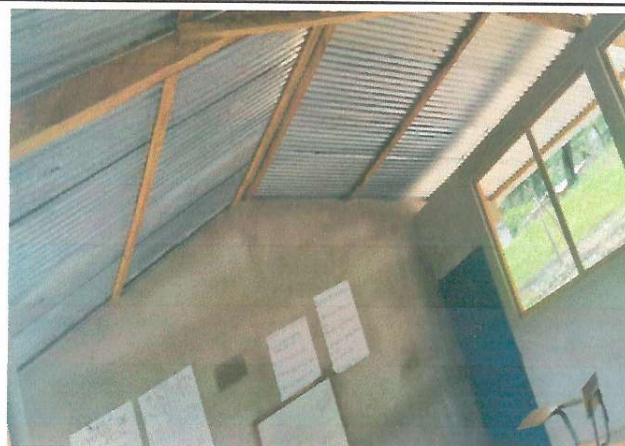
Foto 2: Correspondiente Cambio de cubierta de techo con lamina troquelada calibre 26 y sustitucion estructura portante.
